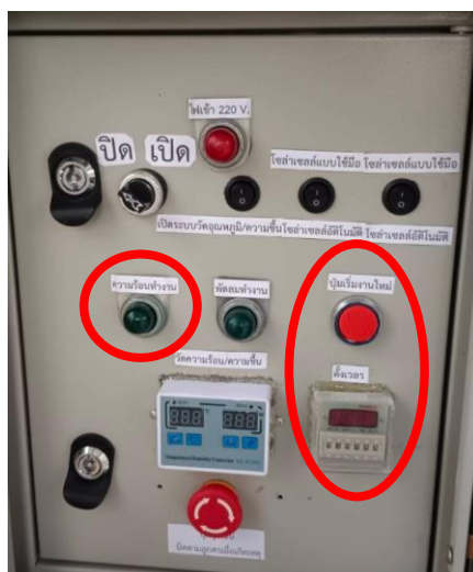
รูปที่ 34 ตำแหน่งตัวตั้งเวลาการทำงาน และตั้งการนับถอยหลังของการทำงาน และหลอดไฟแสดงแสดงสถานะการทำงาน
