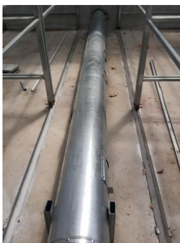
รูปที่ 25 ท่อส่งความร้อน
