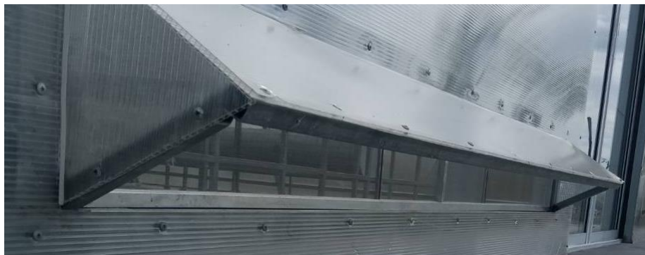
รูปที่ 18 ช่องระบายอากาศ
