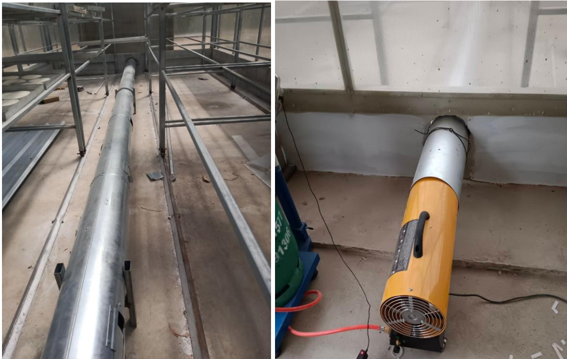
รูปที่ 14 การวางท่อส่งความร้อนและตัวเบิร์นเนอร์แก๊ส LPG
