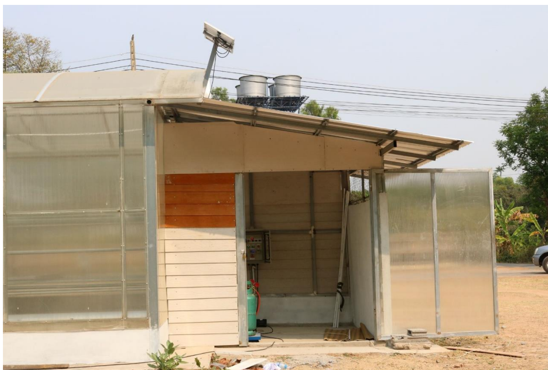
รูปที่ 15 ห้องควบคุมระบบให้ความร้อนเสริมและสภาพอากาศภายในโรงเรือนอบแห้ง
