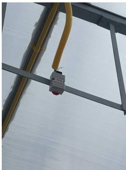
รูปที่ 29 เครื่องตรวจวัดอุณหภูมิและความชื้นภายในโรงอบ
